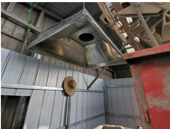
荷兰砖生产线搅拌机集气罩
