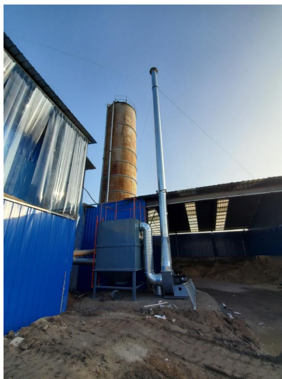
布袋除尘器及排气筒
