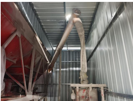
水泥砖生产线搅拌机粉尘收集
